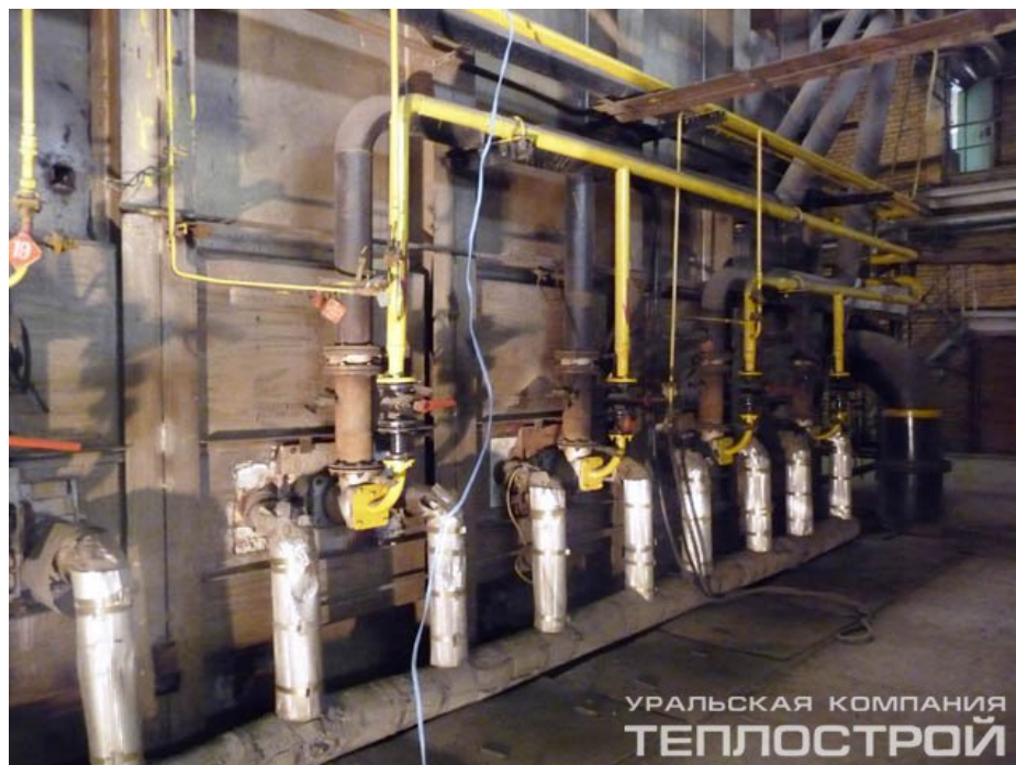
Рисунок 1.9 – Обвес печи арматурой для подачи воздуха и газа
